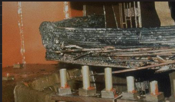
Détérioration d'un transformateur
